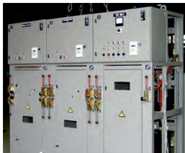
КСО с изолированным релейным шкафом
