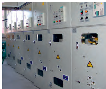
КСО СОБСТВЕННОЙ РАЗРАБОТКИ с расположением выключателя в кассете
