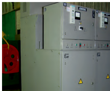
КРУ СОБСТВЕННОЙ РАЗРАБОТКИ с выкатным элементом снизу шкафа
