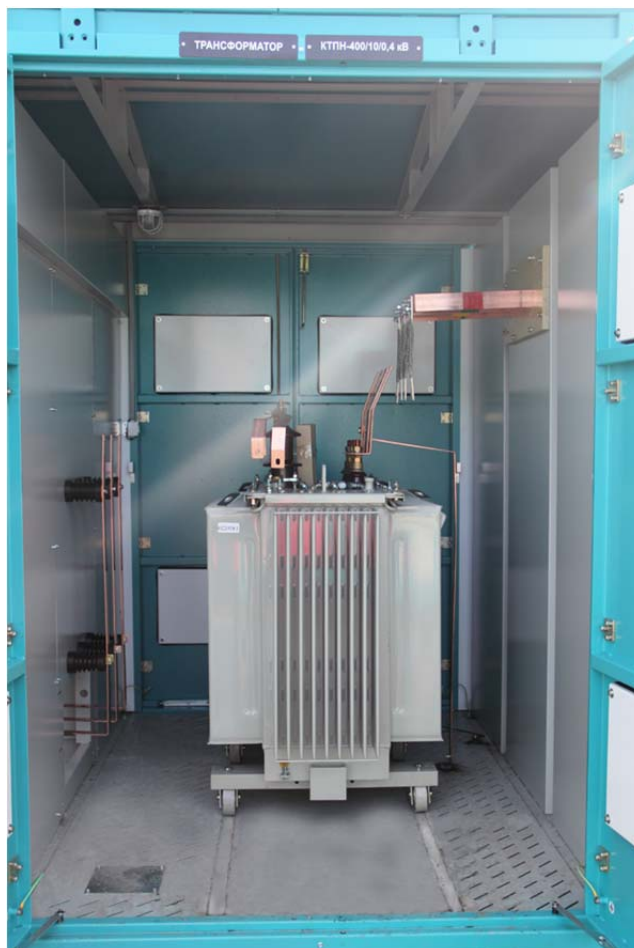
Рисунок 7 Отсек силового трансформатора
